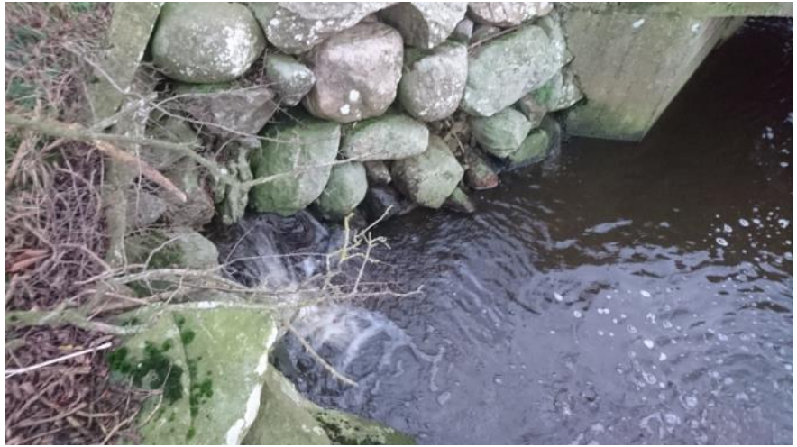
Figur 3.8: Dæmningen er stærkt utæt og en stor mængde vand gennemstrømmer dæmningen i hele dens udtrækning. Her er vist et eksempel hvor vandet strømmer gennem dæmningen umiddelbart opstrøms broen. Foto: NIRAS 2017-11-15
