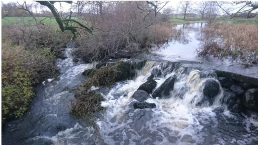
Figur 3.10: Der er etableret et omløbsstryg i den vestlige side af dæmningen (venstre side af fotoet). Foto: NIRAS 2017-11-15
