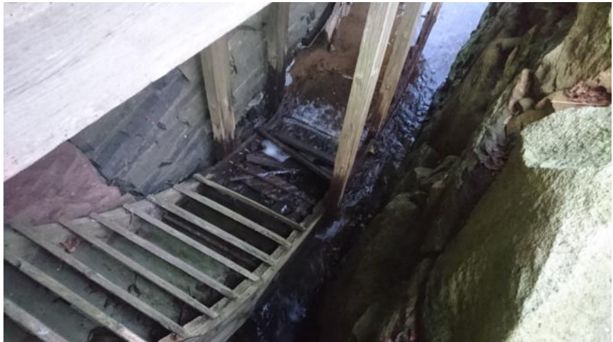
Figur 3.7: Slusen er meget utæt og en væsentlig vandmængde tabes konstant fra søen og forbi møllehjulet. Hvor meget der sker via gennemsvivning af dæmningen, og hvor meget der sker via gennemsvivning af slusen, lod sig ikke afgøre. Foto: NIRAS 2017-11-15
