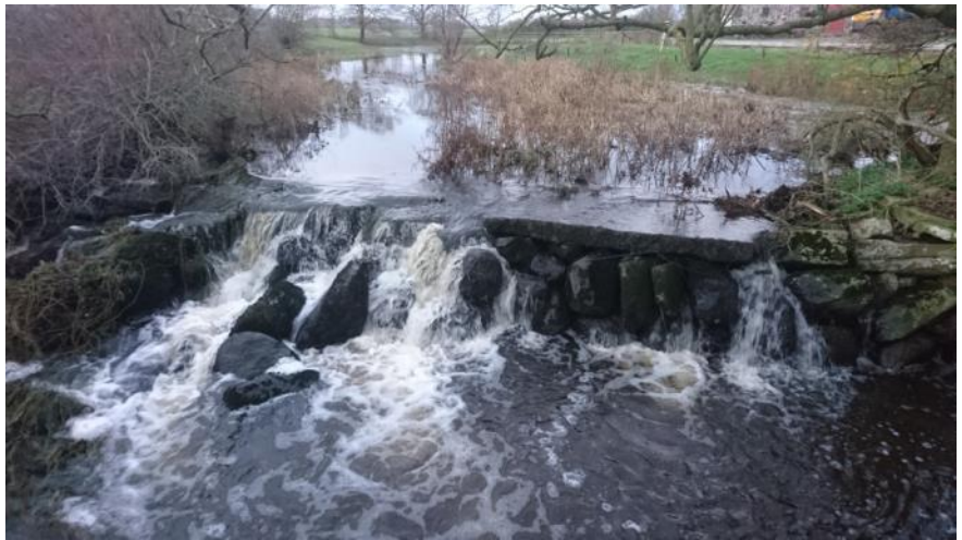
Figur 3.9: Dæmningen er meget utæt, og der løber næsten lige så meget vand gennem dæmningen som over den støbte overside. Stenene er desuden raset sammen på ca. halvdelen af dæmningens længde. Foto: NIRAS 2017-11-15
