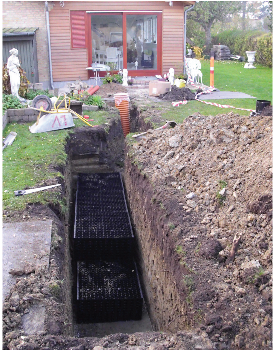
Figur 14: Faskine under udførelse. Tagvandet ledes via en sandfangsbrønd (lodret orange rør) til faskinen i billedets forgrund. Faskinen er opbygget af plastkassetter. Lindevang i Brøndby Foto Spildevandscenter Avedøre.
